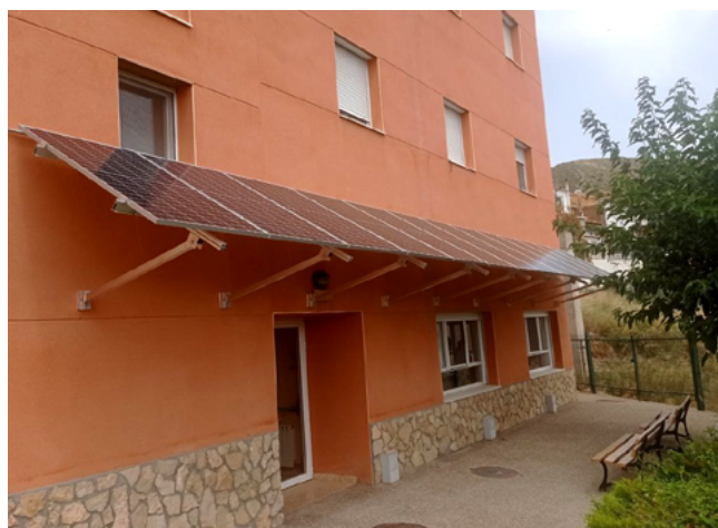
/ Módulos fotovoltaicos instalados en la fachada de la residencia
